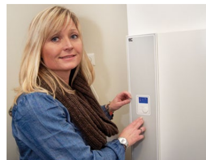
BALANSERT VENTILASJON: Temperaturen i hvert enkelt rom styres fra denne sentralen. Det eneste vi gjør, er å justere luftmengden, forklarer Margrethe Lia.
