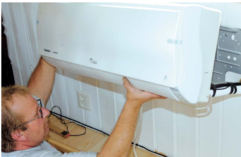
INNEDEL: Det er viktig at innedelen av varmepumpa blir plassert riktig, understreker Kjell Høydal.
