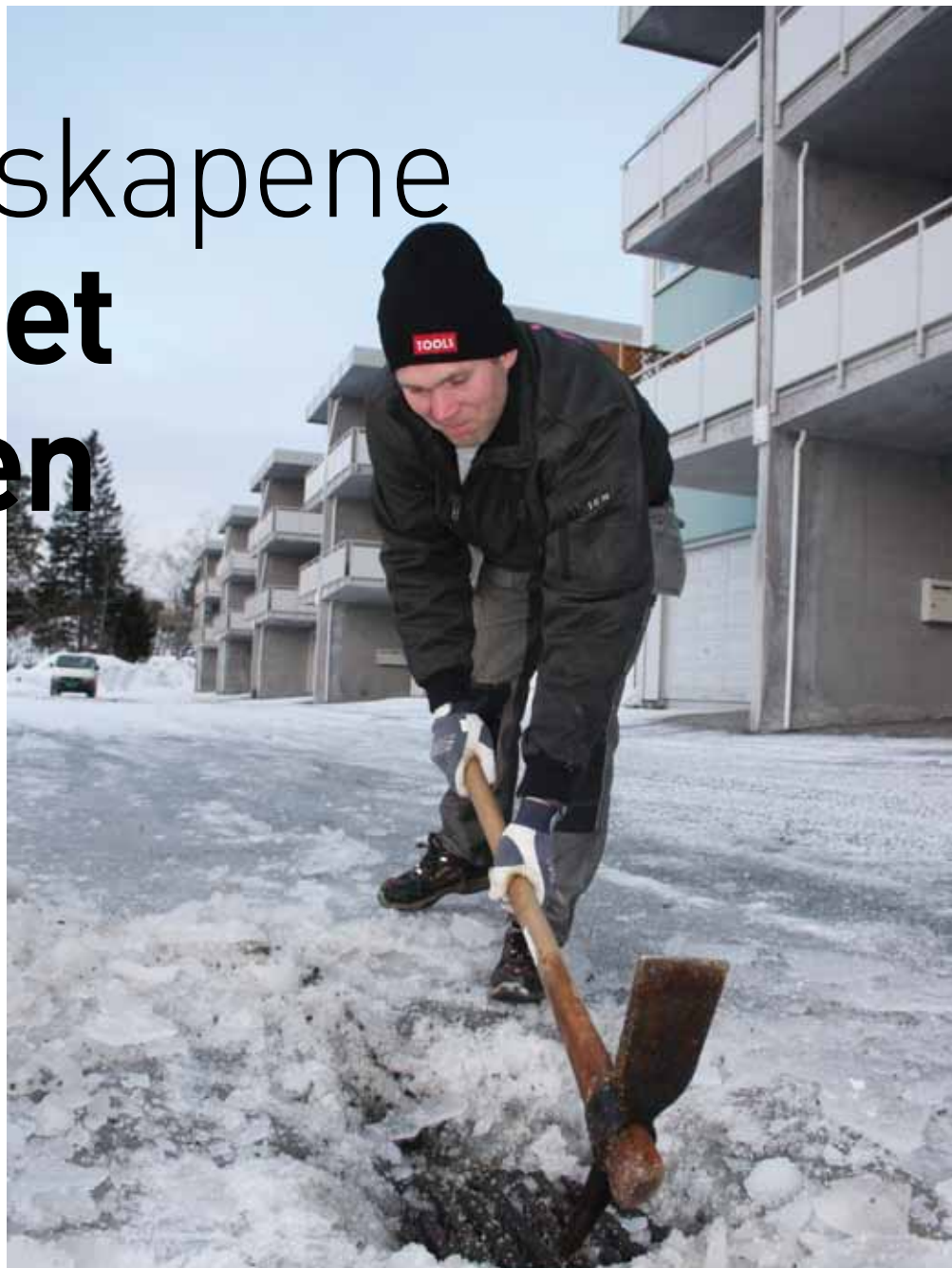
Vaktmester Allan Slemmen i MOBO Servicesentral har sørget for å åpne mange frosne sluker rundt i borettslag, sameier og barnehager og åpner avløpsrørene ved å bruke grovsalt om nødvendig. Her har han fikset en sluk i Bergsgjerdet Borettslag og fått vekk overvann.
