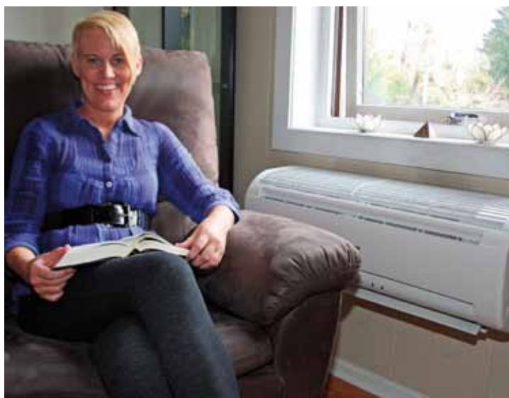
Styreleder Linda Finsrud koser seg med en bok foran den nye varmepumpen.
