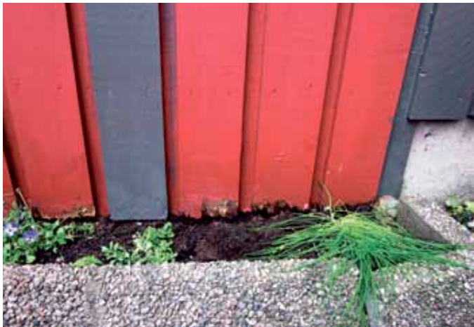
RÅTE: Busker og vekster ved veggene må klippes slik at ikke snøen blir liggende oppover kledningen. Bildet viser råteskader som skyldes dårlig lufting nederst på veggene.
