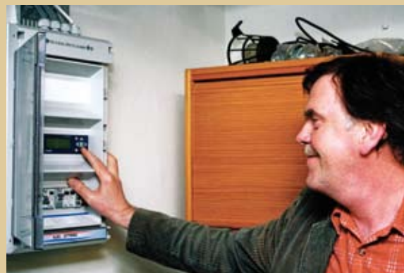
Prosjektleder Geir Haugen i Bergum Borettslag i Førde kontrollerer innstillingene i styringsboksen.
