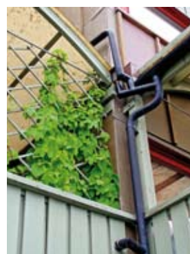
Slike håpløse taknedløp blir snart en saga blott.
