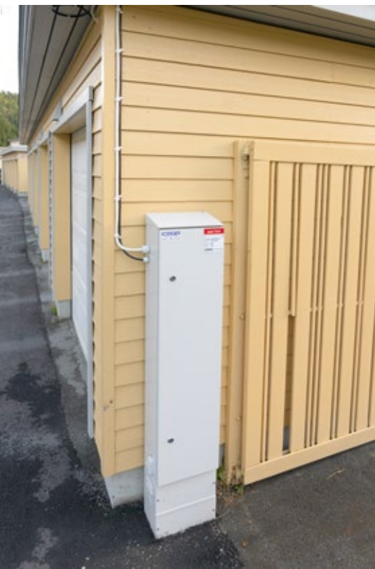
▲ Strømtilførsel ved garasjene i Farstadplassen borettslag.
